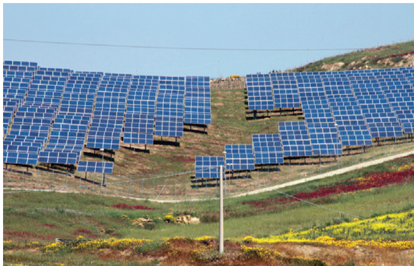
Figura 2. Impianto fotovoltaico. Fonte: foto dell'autore.
