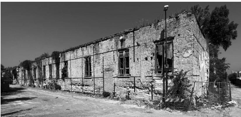
Fig. 2 - (Sopra) Le corti del Pio Monte della Misericordia riutilizzate come deposito dei detriti successivamente al fenomeno alluvionale. (Sotto) Fotografia di uno dei corpi del Pio Monte della Misericordia in cui il degrado superficiale permette d'osservare il sistema strutturale della struttura baraccata. Foto degli autori.
